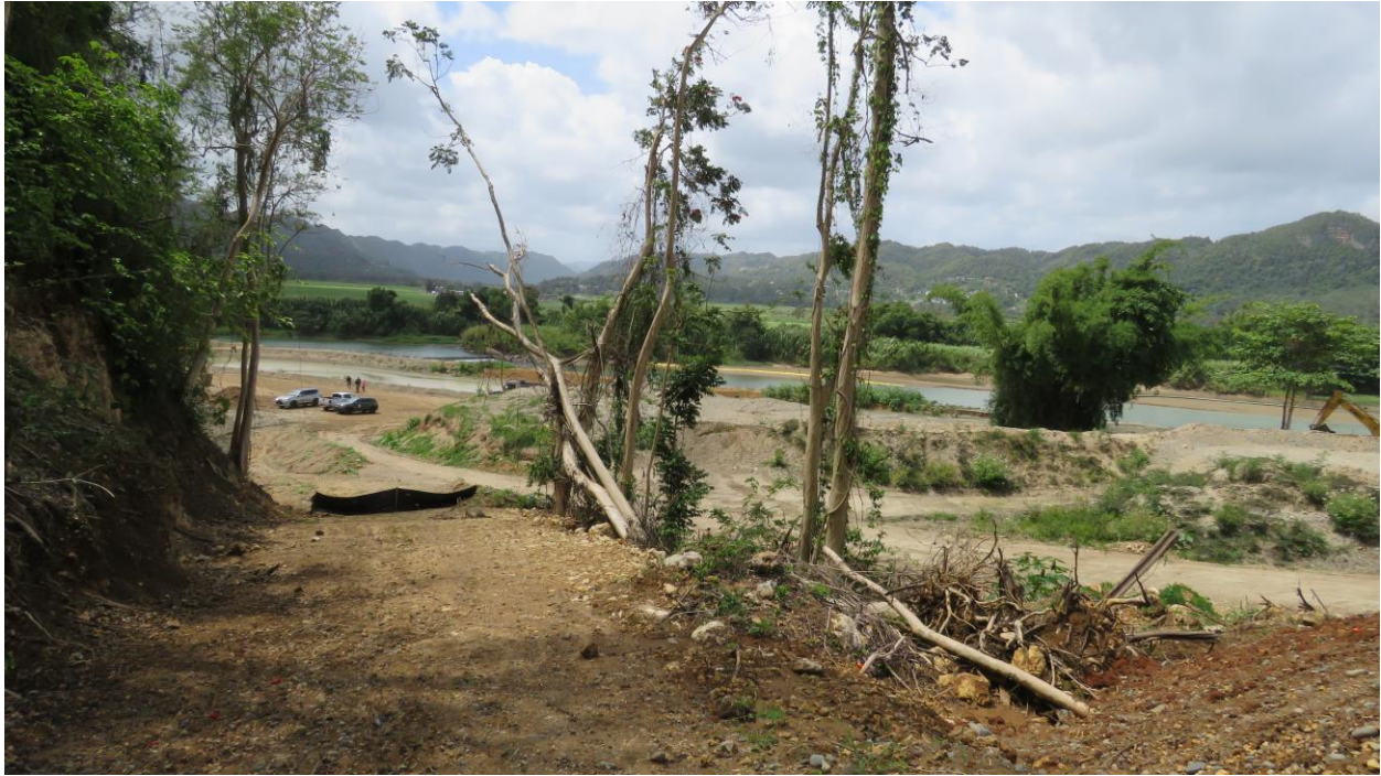
Imagen 8. Implementación deficiente del plan para el control de escorrentías y sedimentos.
